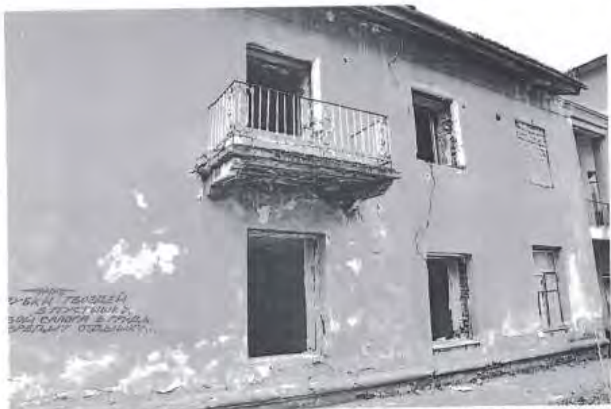
Фото 1. Разрушение и искривление наружных стен. Отсутствие оконного и дверного заполнения. Трещины в наружной стене шириной раскрытия до 28,5 мм. Разрушение отделочного покрытия
