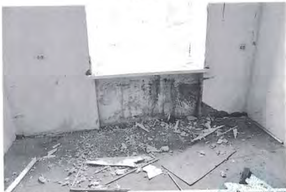
Фото 2. Отсутствие оконного заполнения. Разрушение системы отопления. Разрушение отделочного покрытия
