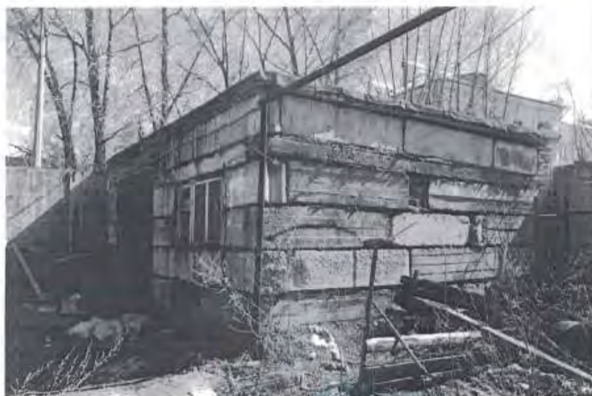
Фото 4. Разрушение заполнения между блоками, деструкция бетона отдельных блоков несущих стен (здание гаража № 2)
