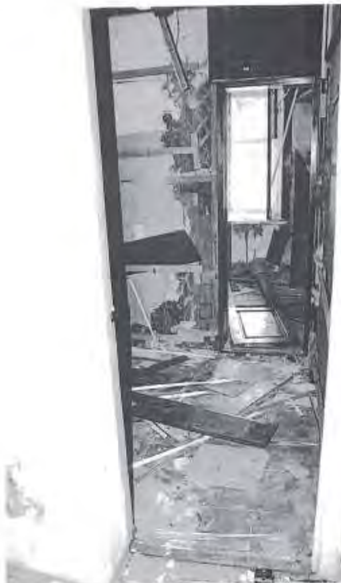
Фото 5. Разрушение внутренней отделки помещений. Разрушение полов и перегородок
