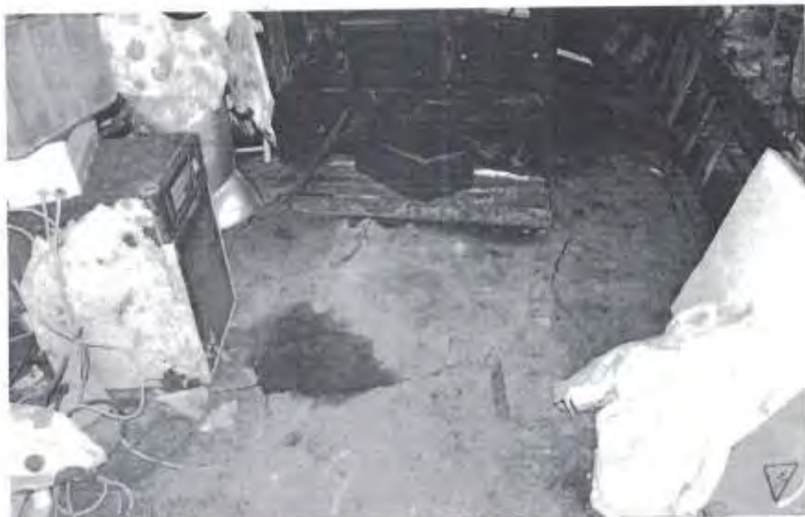
Фото 1. Многочисленные, разнонаправленные трещины в бетонном полу. Провалы пола до 55,0 мм (здание гаража № 1)
