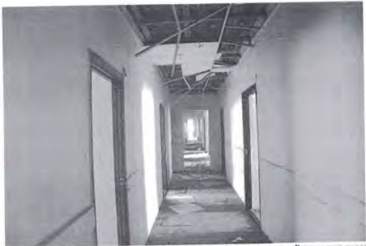
Фото 3. Отсутствие дверного заполнения. Разрушение отделки потолков. Разрушение полов
