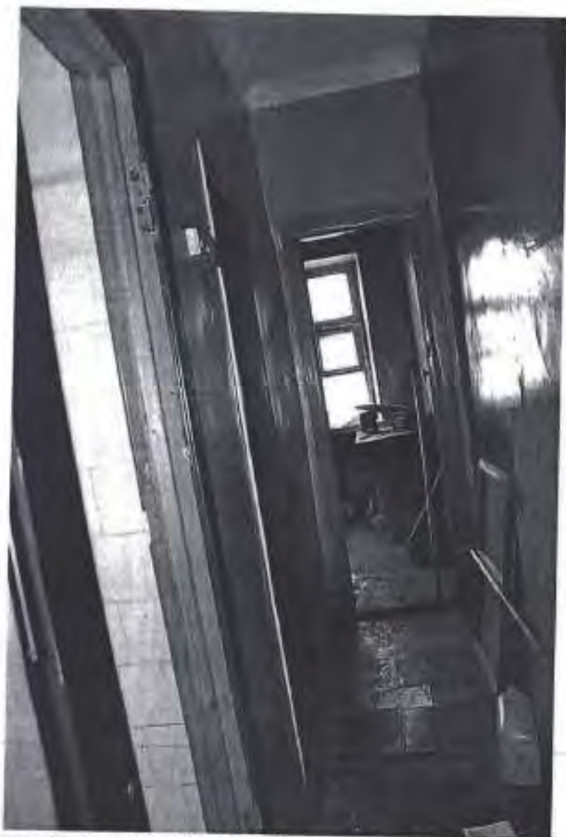
Фото 1. Искривление внутренних перегородок. Разрушение заполнения дверных проемов. Разрушение полов, прогиб до 55 мм
