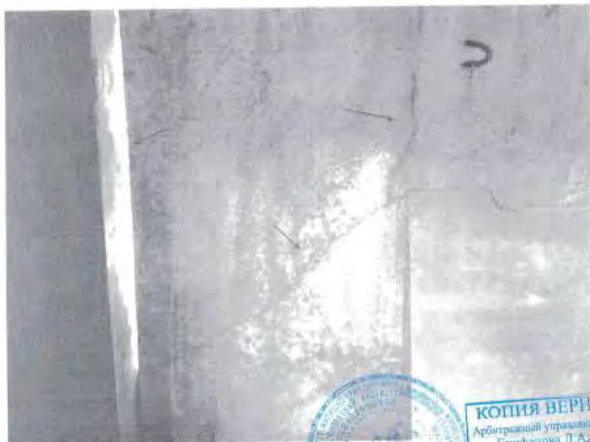
Фото 2. Трещины в железобетонных стенах. Раскрытие межпанельных швов (здание гаража № 1)
