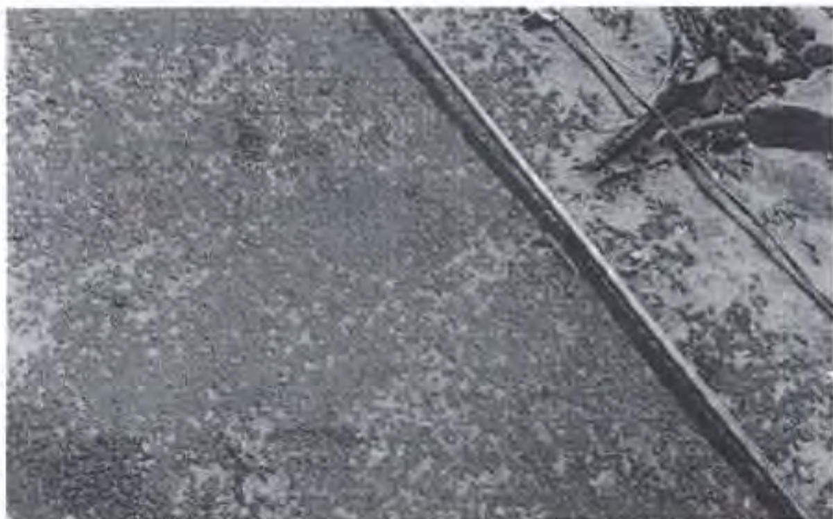
Фото 3. Разрушение кровельного гидроизоляционного ковра (здание гаража № 1)
